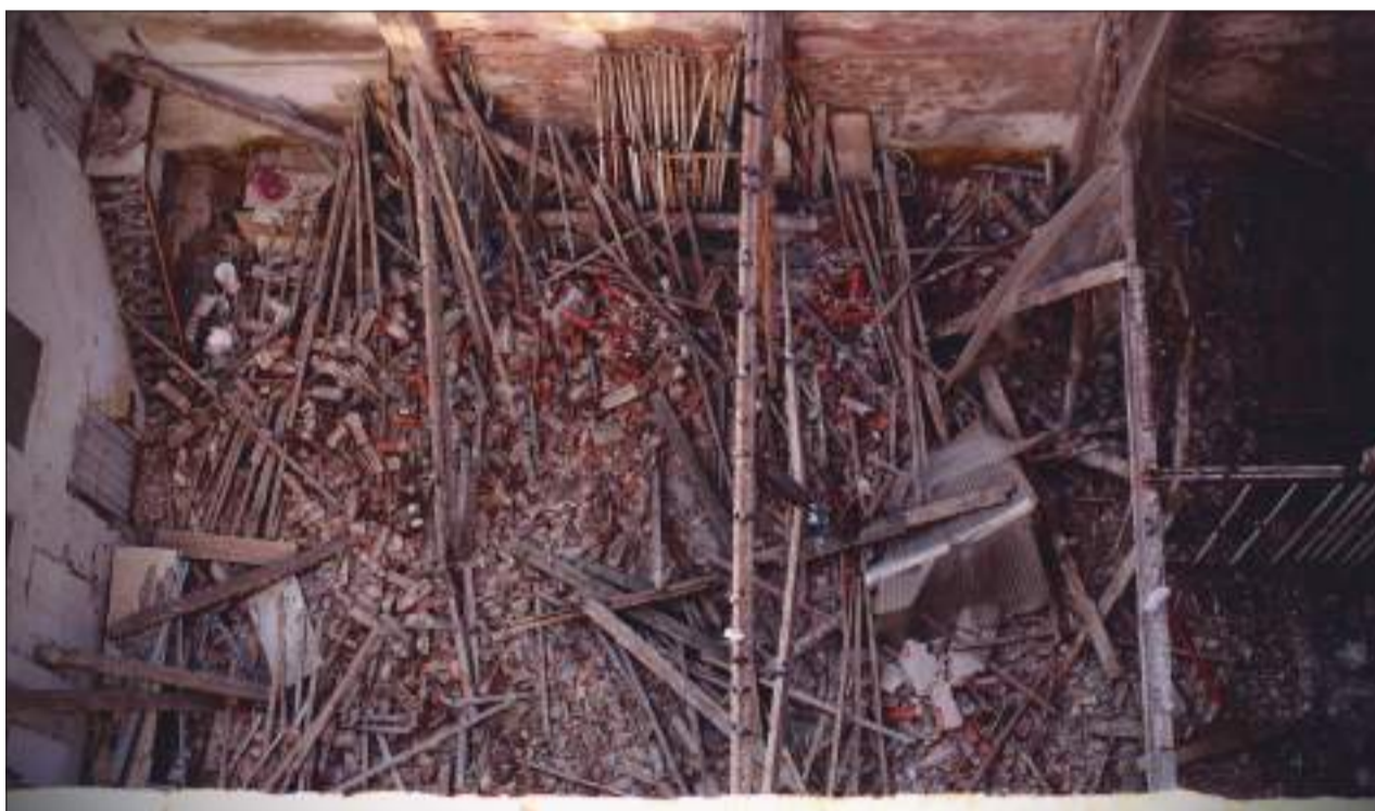
La finca de Piquer 10, vista des d'una terrassa veïna, completament enfonsada i plena de coloms
